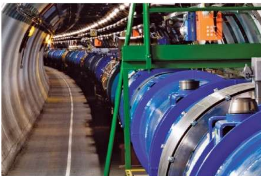
Interior del túnel del LHC, con los imanes dipolares instalados y listos para entrar en funcionamiento. © CERN
